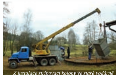
Z instalace stripovací kolony ve staré vodárně
