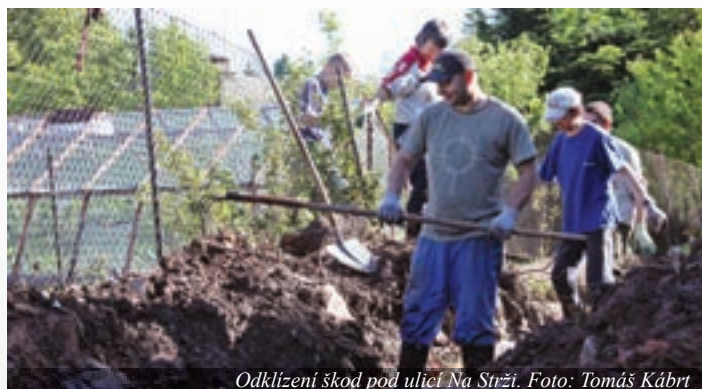
Odklizení škod pod ulicí Na Strži. Foto: Tomáš Kábrt
